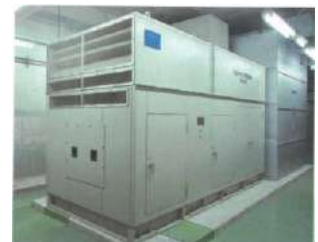
非常用発電機
